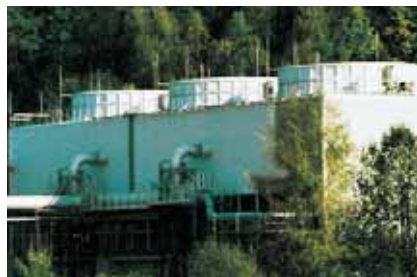
Innovationsbeispiel 2 Rückkühlanlage in einer Zellstoff- und Papierfabrik
