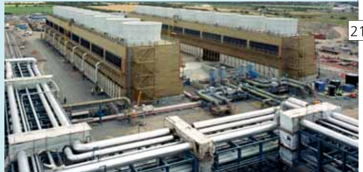
Système de refroidissement hybride (18 cellules), Grande-Bretagne
