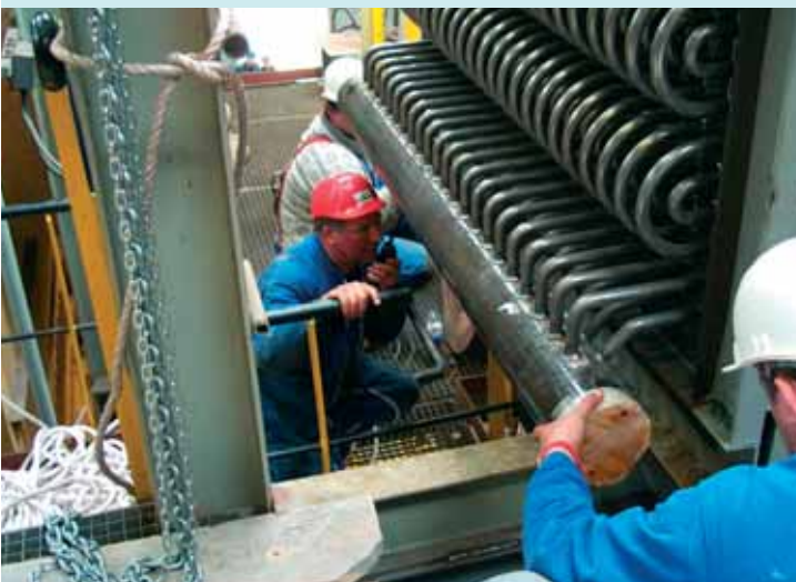
Récupérateur de chaleur (détail)
