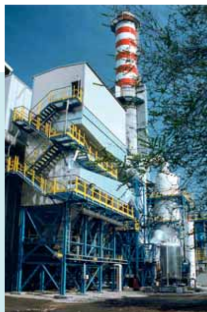
Filtere à manche, Bolzano, USA
